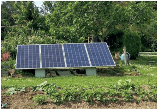
Solaire au sol
